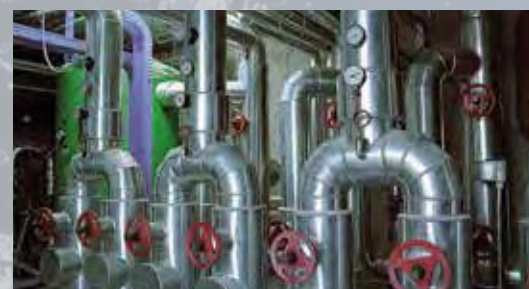
50 ANNI DI IMPIANTI
